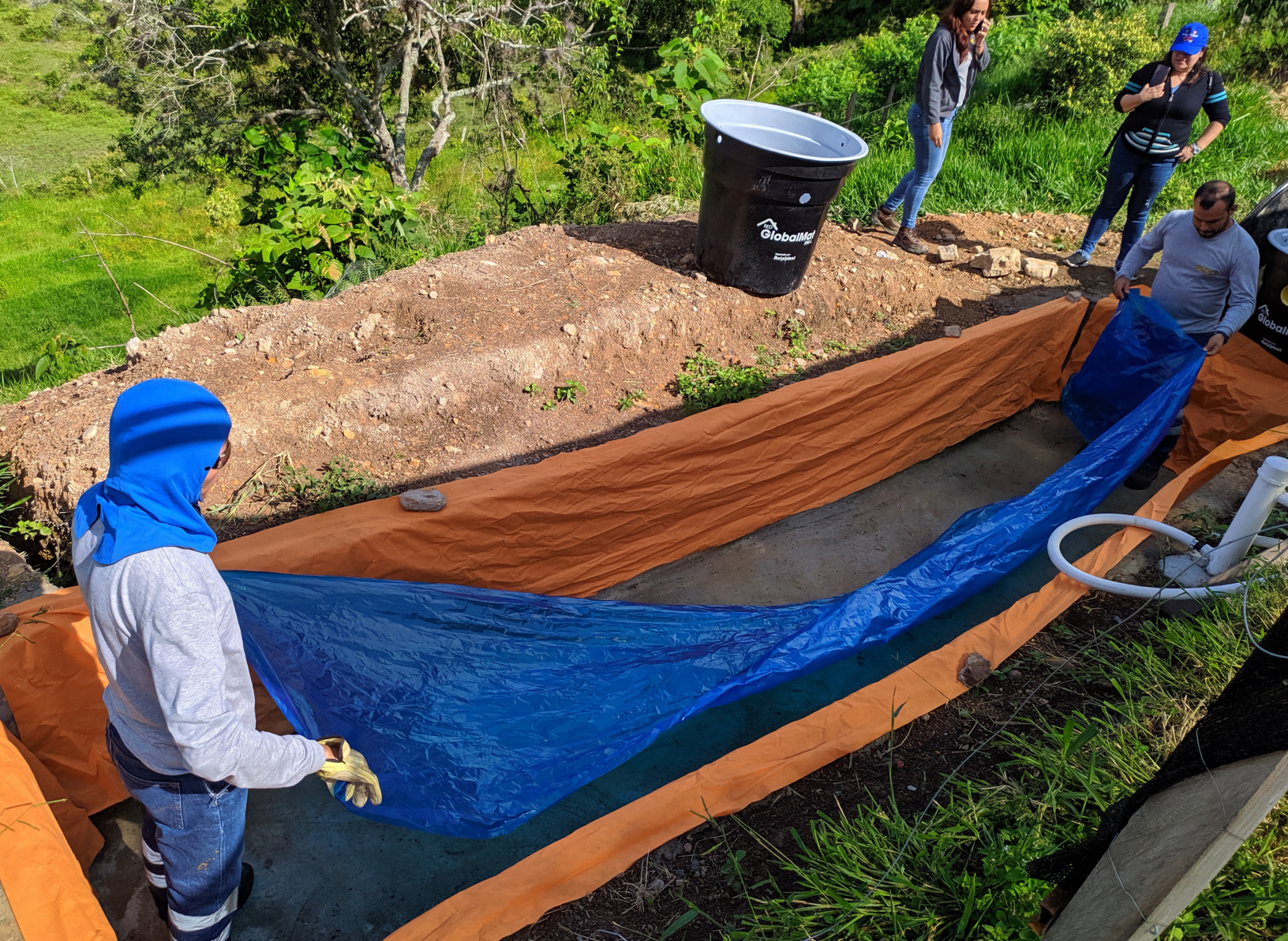
Figura 1. Instalación biodigestor Dolores, Tolima
