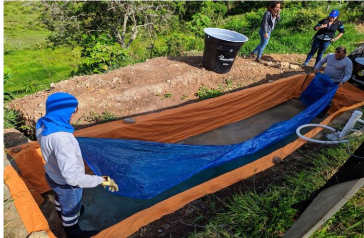
Figura 1. Instalación biodigestor Dolores, Tolima
